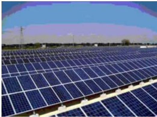
CAMPO FOTOVOLTAICO A TERRA
