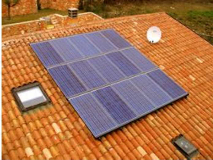
TETTO FOTOVOLTATICO A FALDA
