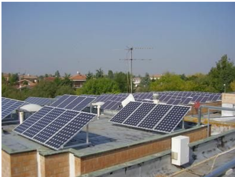
TETTO FOTOVOLTAICO PIANO
